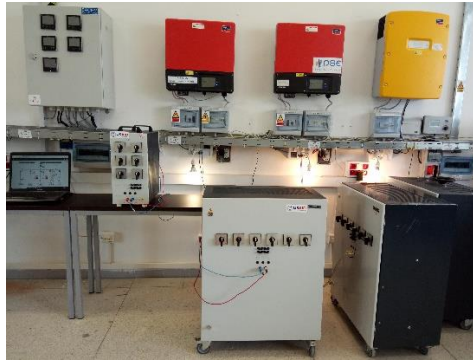
Figure 1 : Vue de Face de la Plateforme Pla-NeTE, dans la salle Qehna de l'ENIT
