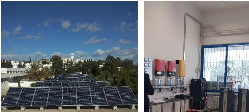
Figure 2 : Modules PV sur le Toit (a) et dans la salle Qehna (b)
